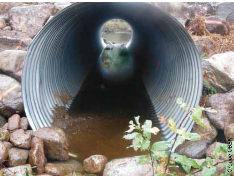
Figure 5.15 Ponceau circulaire avec substrat
