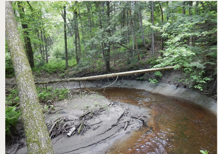
L'érosion en bas de talus peut déclencher un glissement de terrain. © Ministère des Transports et de la Mobilité durable (MTMD)
